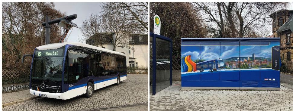
Abbildung 2-36 Beispiel für eine konduktive Energieübertragung an einer Endhaltestelle (Jena, Linie 14)
